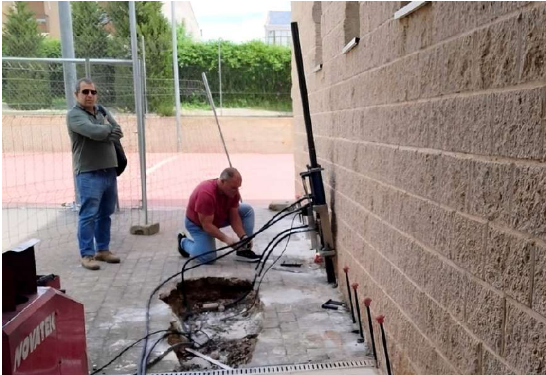
Aqualia indemniza a La Solana por los daños en el pabellón
