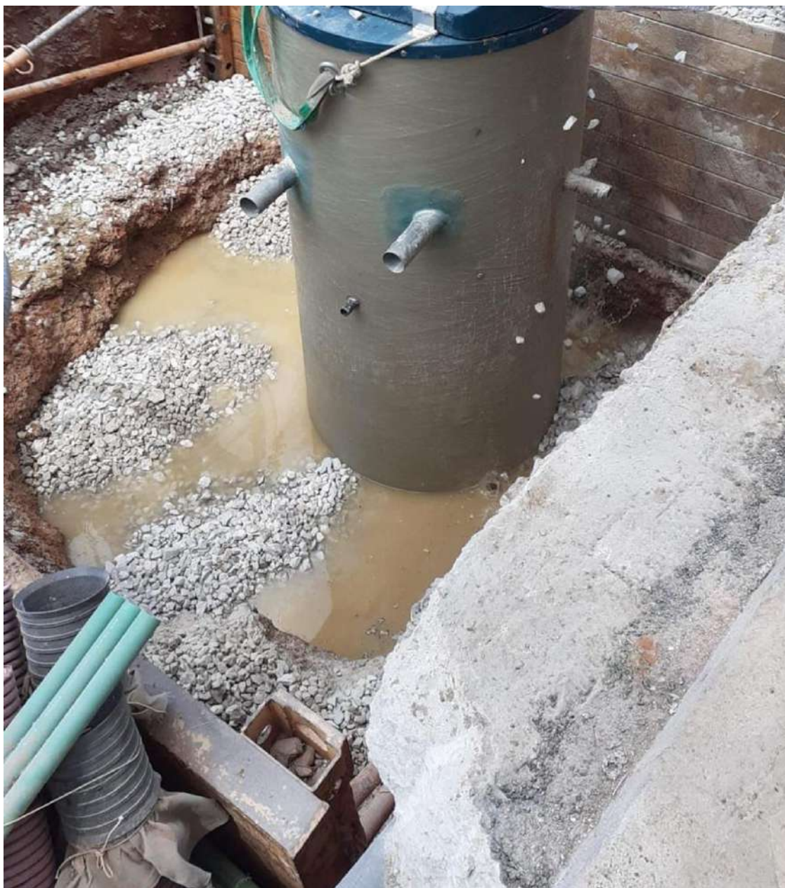
La nueva estación cuenta con dos bombas / Levante-EMV
